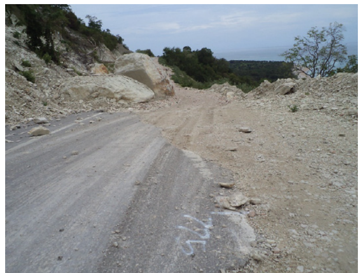
Saluran tepi jalan yang tertutup material longsor
