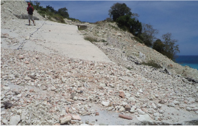
Kaki bukit yang rawan bahaya longsor
